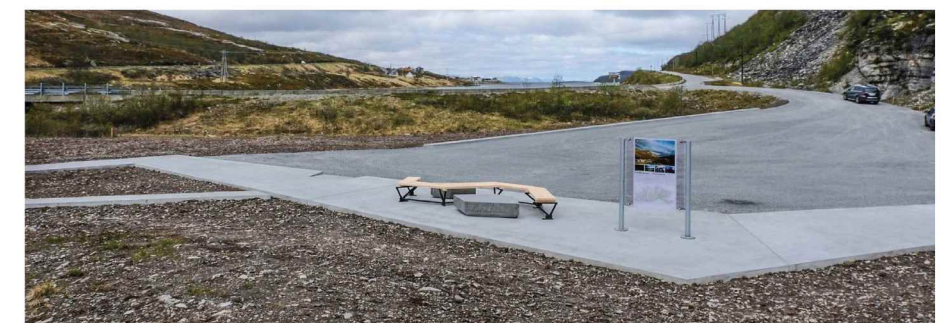
Overgang mellom asfalt grus og betong
