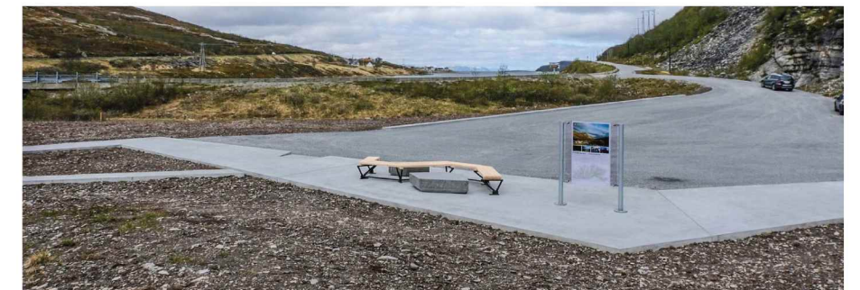
Overgang mellom asfalt grus og betong
