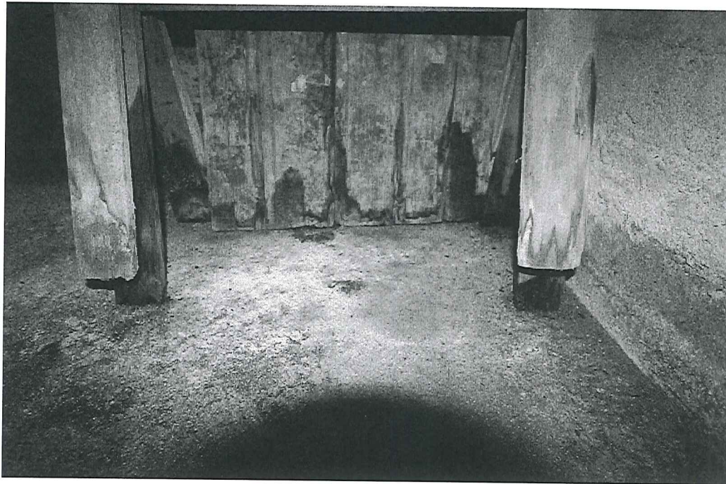
Eksempel fra fukt i kjeller.
