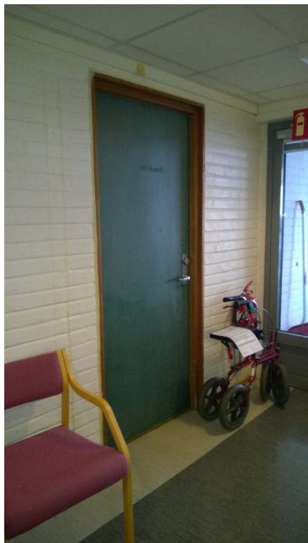
Bilde 7 Eldre eksisterende dører har ikke sertifisert brannklasse.
