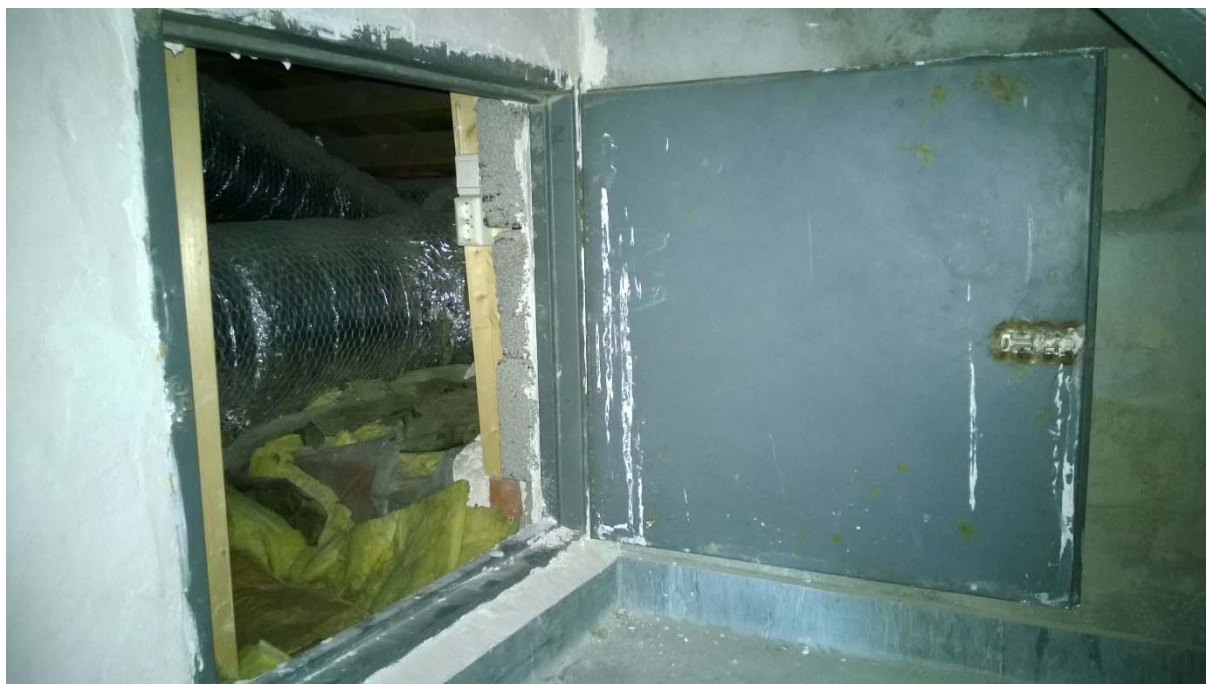
Bilde 9 Luke fra teknisk rom til loft har ikke sertifisert brannmotstand.
