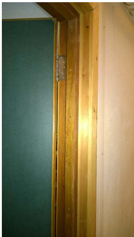
Bilde 10 Dør i andre etasje til teknisk rom har ikke sertifisert brannmotstand.
