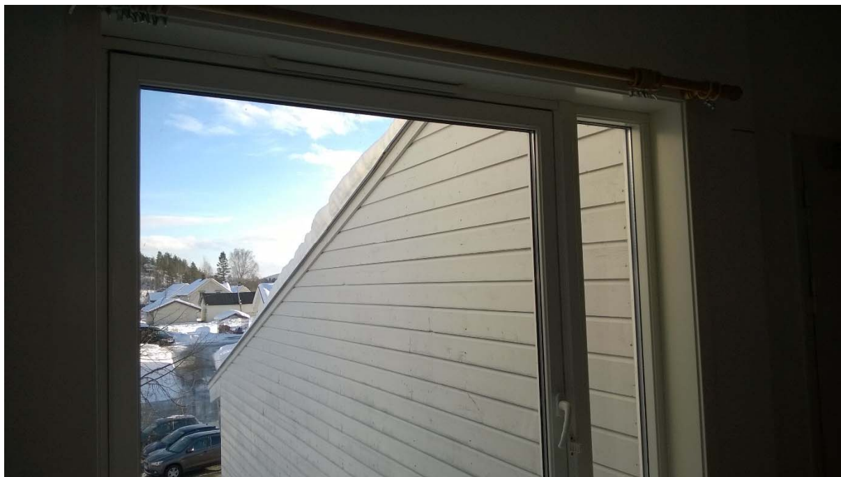
Bilde 2 Seksjoneringsvegg mot tilliggende boliger er ikke ført over tak eller opp til tak med E160 konstruksjon.
