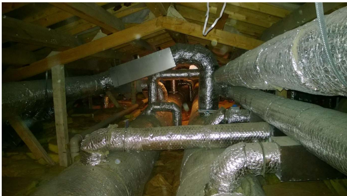
Bilde 1 Seksjoneringsvegg er ikke ført opp på loft eller over tak. Det anbefales evt. å etablere en branncellebegrensende vegg i dette området på loftet.
