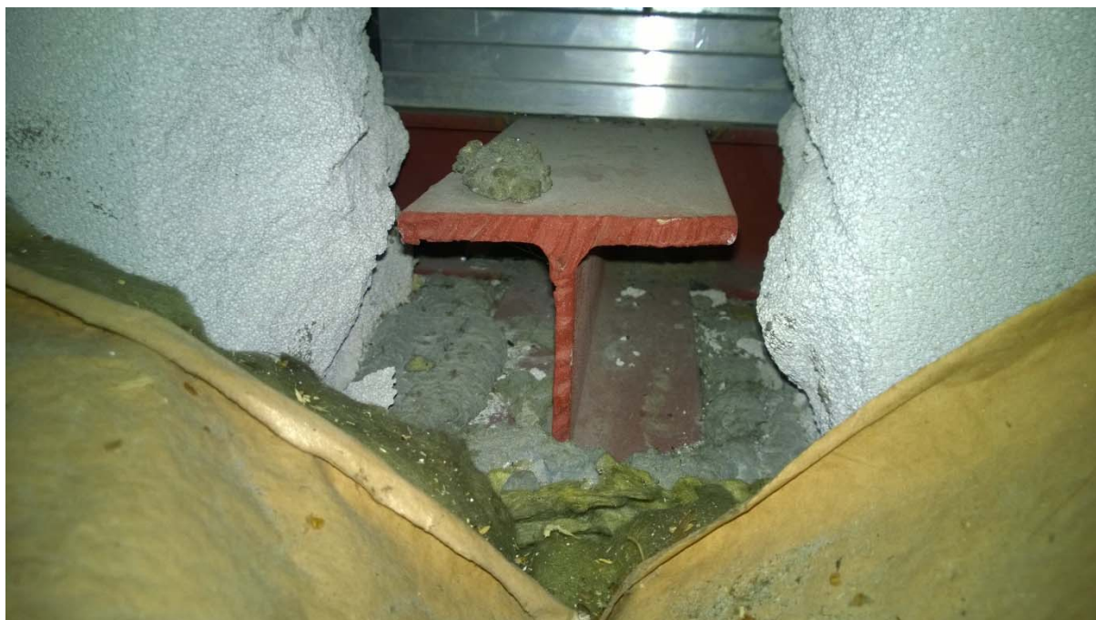
Bilde 16 Opplegg for bæring av ventilasjonsaggregatet var ført igjennom branncellebegrensende vegg.
