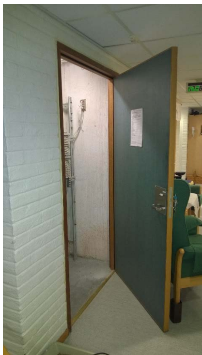
Bilde 11 Dør i alle etasjer til tavlerom har ikke sertifisert brannmotstand.
