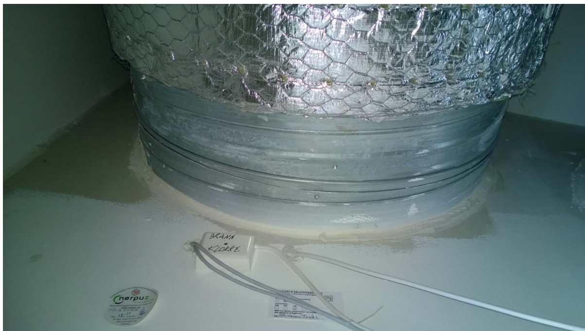
Bilde 15 Brannisolering er ikke avsluttet helt til vegg.
