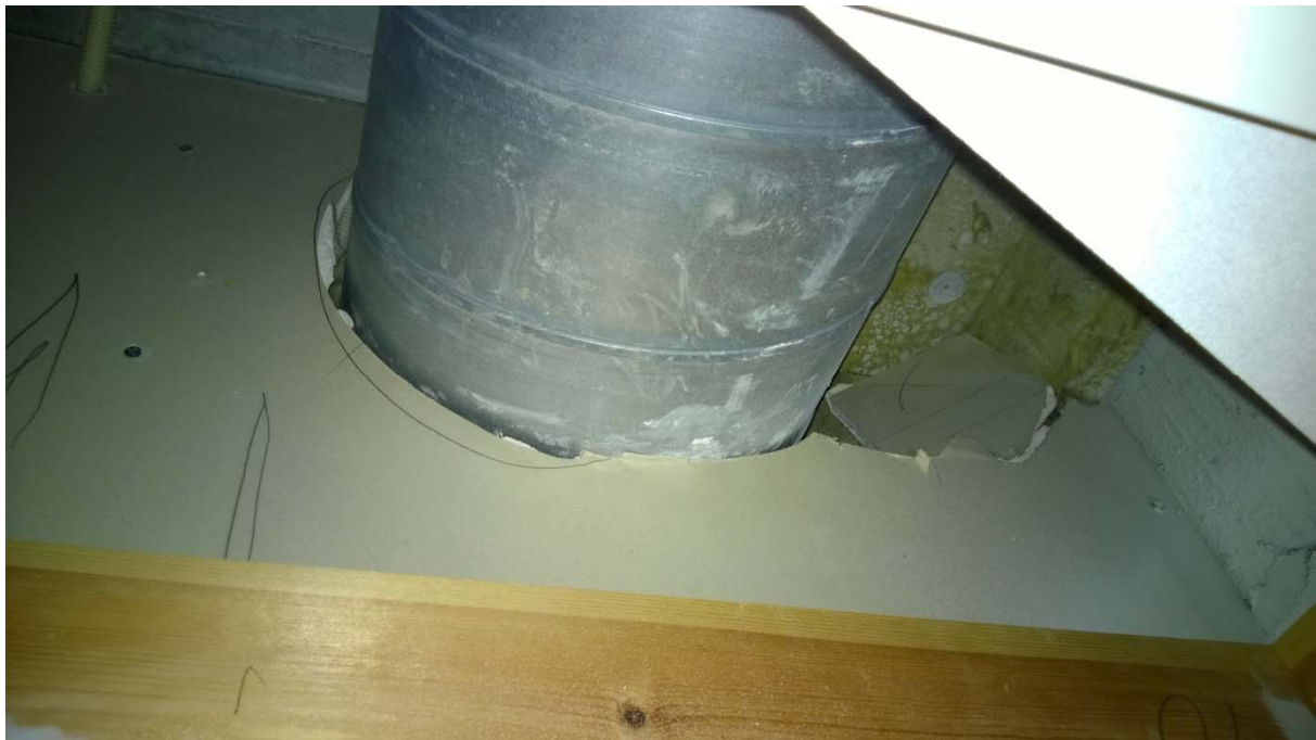
Bilde 14 Kanal må branttettes og brannisoleres.
