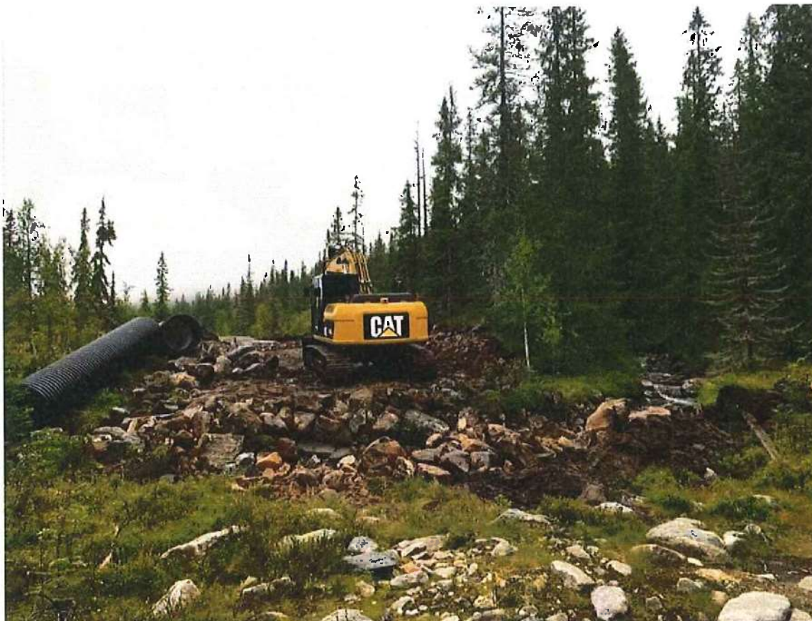
Foto: Det urbane friluftsliv har inntatt Norefjell. Anlegg av «sykkelsti» mellom Tempelseter og Leppejuv.
